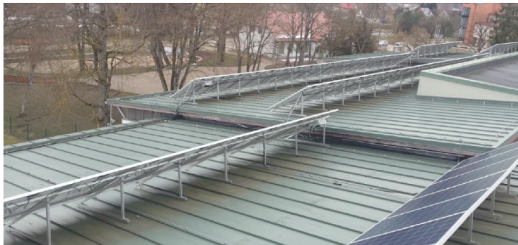
Saulės elektrinė ant Jaunmarupės pradinės mokyklos stogo (Marupės r., Latvija)
