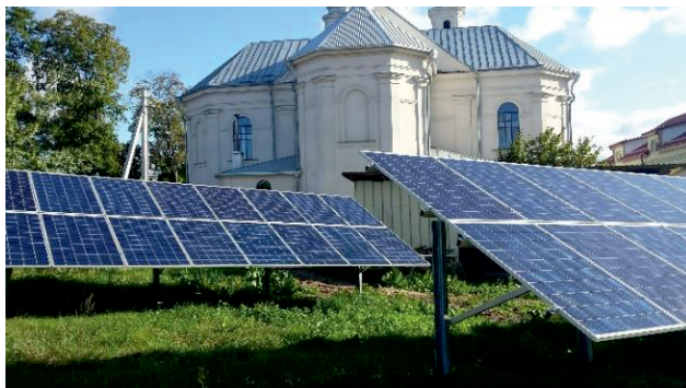
Nuotraukoje: Švč. Trejybės bažnyčios saulės elektrinė
