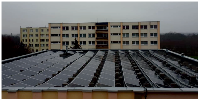
Nuotraukoje: bendras saulės elektrinės vaizdas
